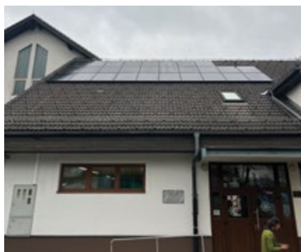
SONČNA ELEKTRARNA VVZ SORA
