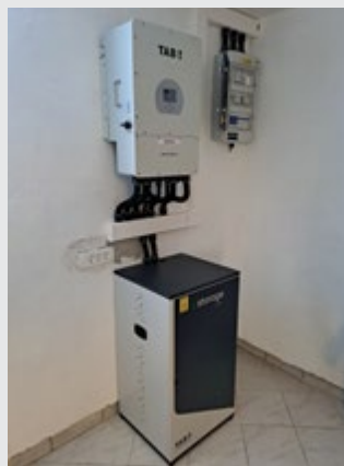
BATERIJSKI HRANILNIK ELEKTRIČNE ENERGIJE Foto: Arhiv Elektra Gorenjska
