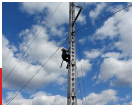
V VOLČAH JE POTEKALA SKUPNA VAJA SKUPINE GIZ ZA ODPRAVLJANJE POSLEDIC NEURIJ IN VREMENSKIH UJM NA OMREŽJU – FOTO: ARHIV ELEKTRA GORENJSKA
