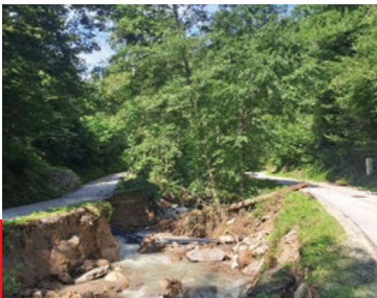
ŠKODA NA DISTRIBUCIJSKEM OMREŽJU ELEKTRO GORENJSKA ZARADI NEURJ FOTO: ARHIV ELEKTRO GORENJSKA
